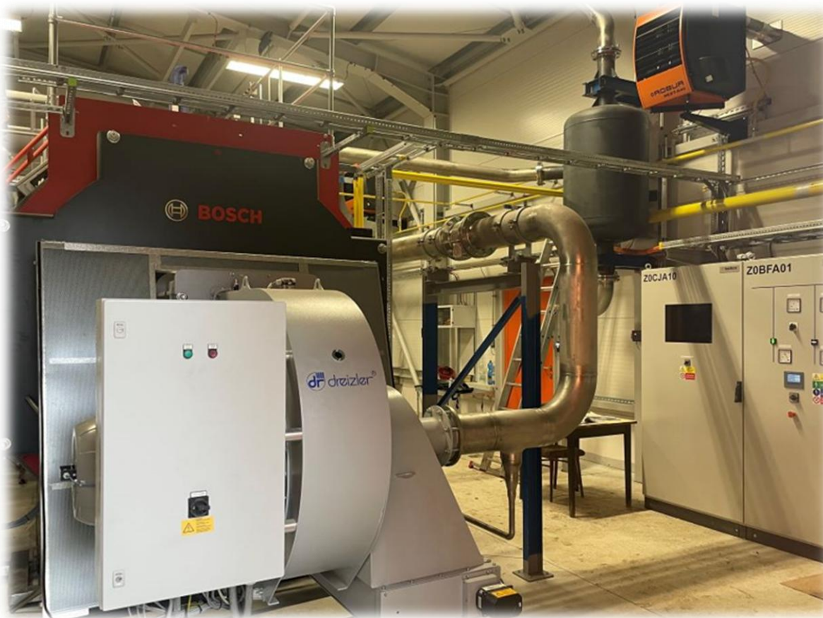
Pohled na kotel ze strany od hořáku, rozvaděče řídicího systému a elektro
